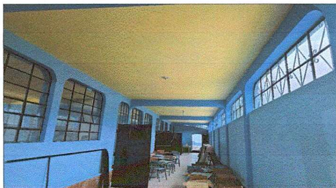
Foto 4: PINTURA EN PAREDES EXTERIOR E INTERIOR. CAMBIAR FOTO
